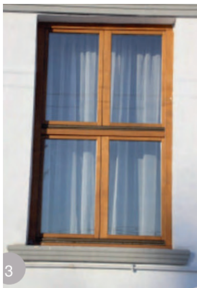
Exemplu tâmplărie geam. Sursa : Ghid de arhitectură pentru încadrarea în specificul local de mediu rural Țara Chioarului
