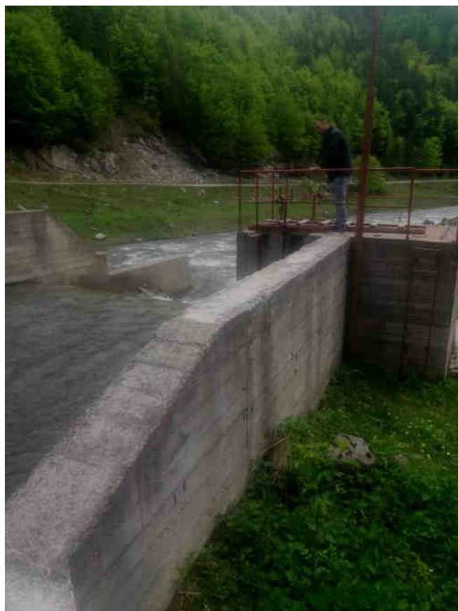
Foto nr. 15 Captare existenta In localitatea Poienile de Sub Munte
