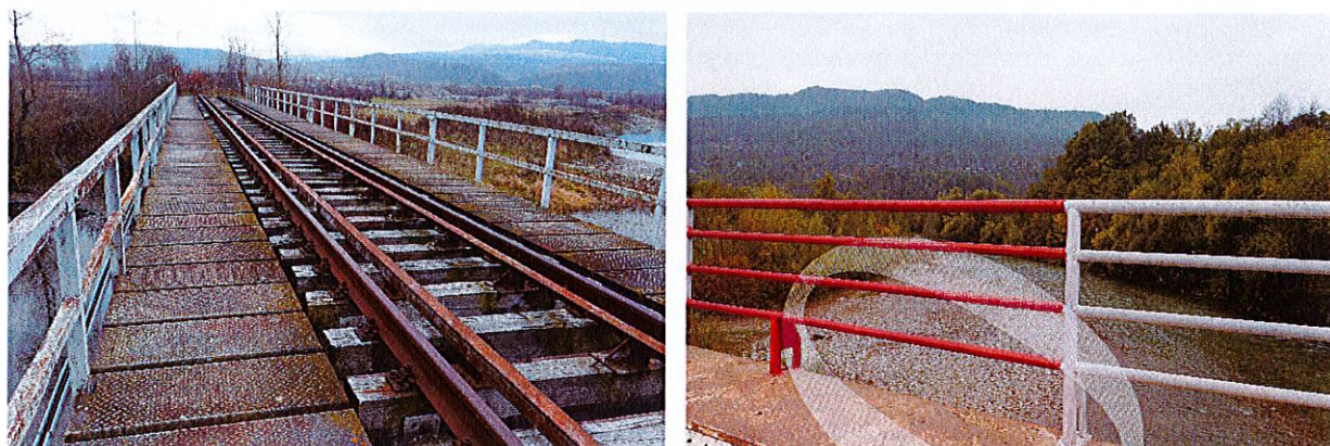
Figura 125/Anexa 2. Căi ferate (D01.04 căi ferate, căi ferate de mare viteză), poduri (D01.05 poduri, viaducte), plante invazive (I01 specii invazive non-native (alogene)),
